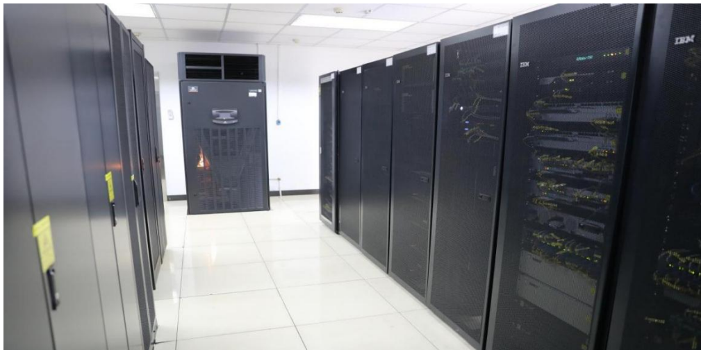
图3 数据中心机房
