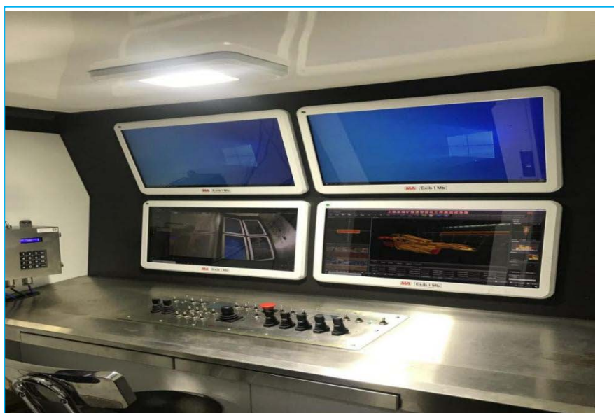
图 3 智能掘进井下集控中心
