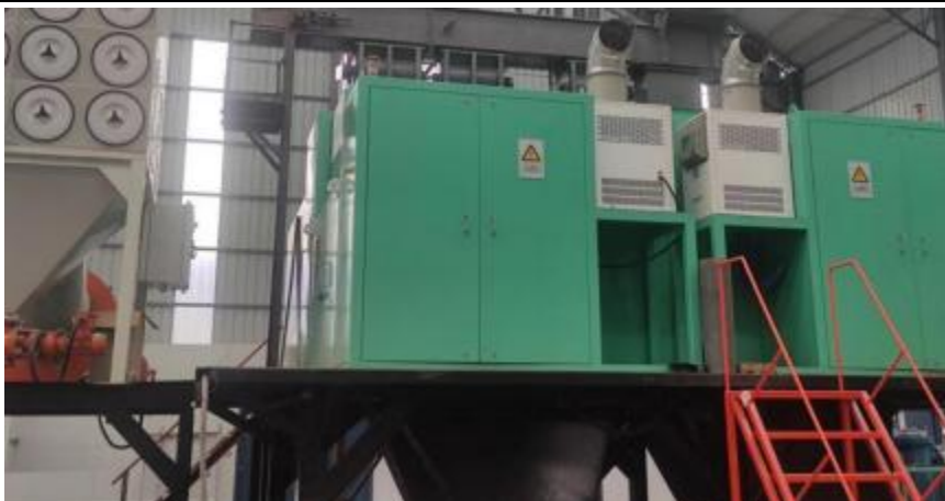
图 2 VCS 智能干式选煤机现场图
