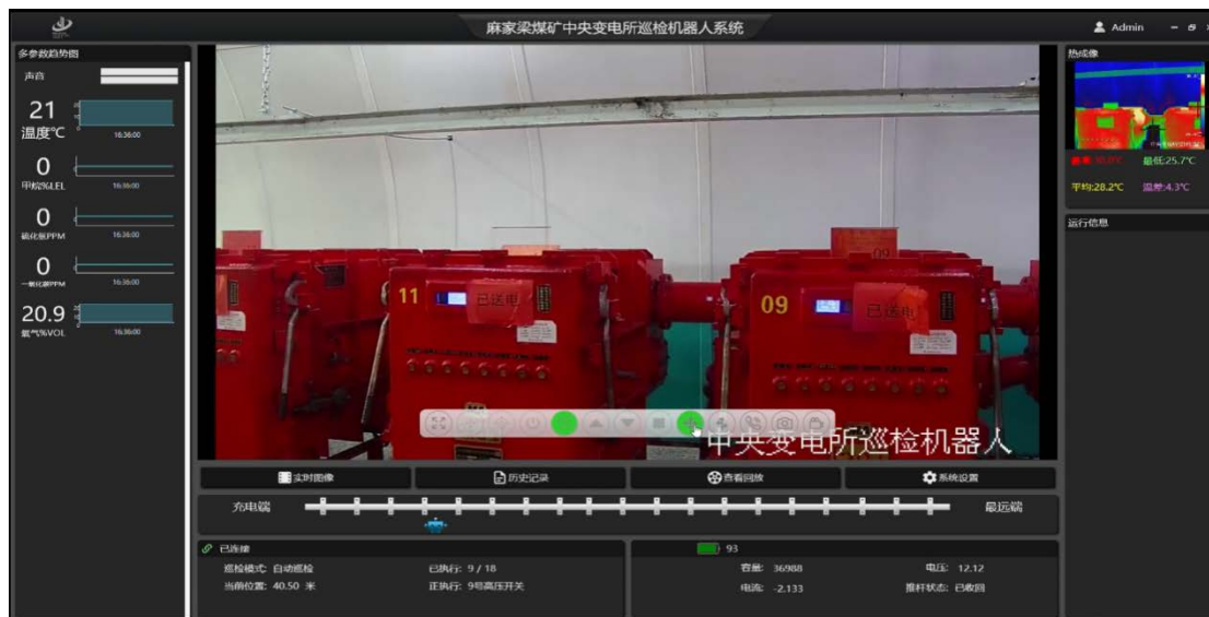
图3 中央变电所巡检机器人
