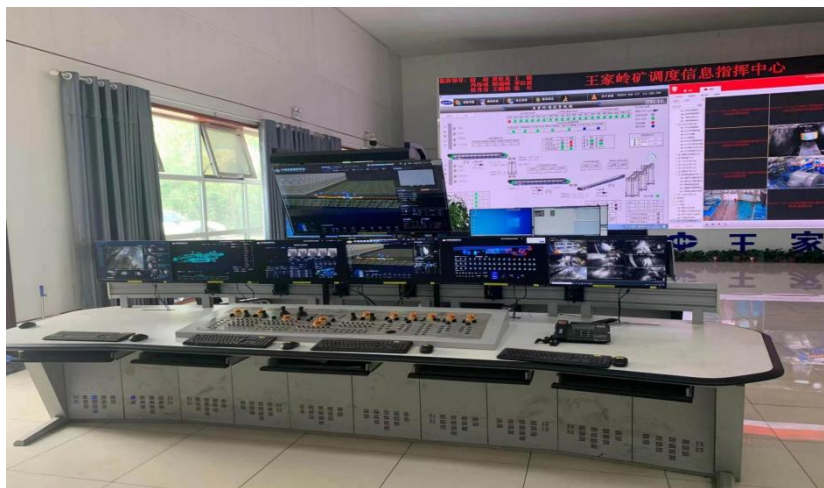
图5 地面集中控制系统
