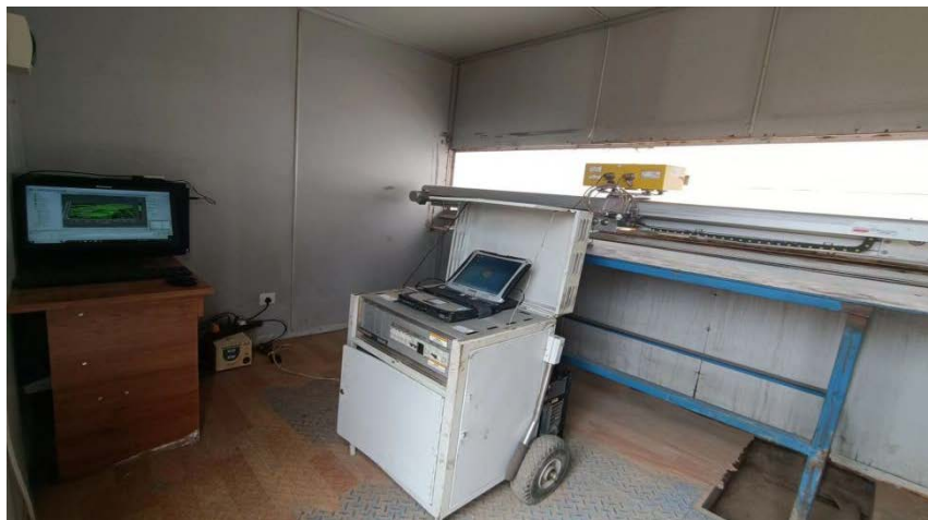
图1 边坡雷达监测系统
