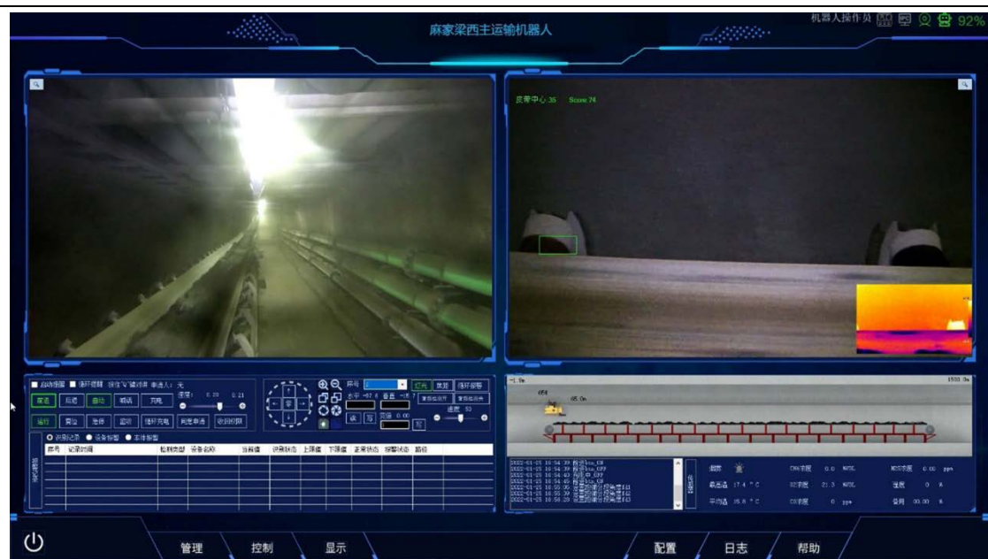
图4 胶带巡检机器人
