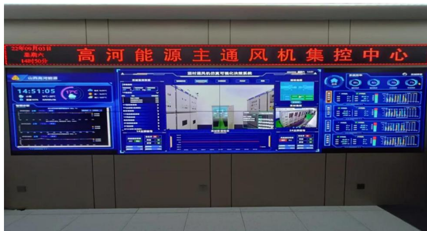
图 4 主通风机集控中心
