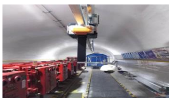
机电硐室巡检
